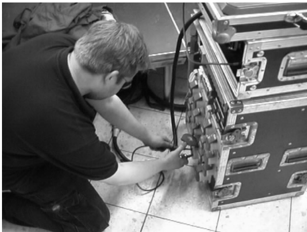
Überprüfung der Energieversorgung
